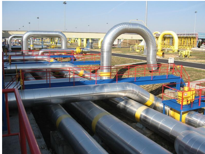
Obr. 2 Potrubný dvor kompresorovej stanice
